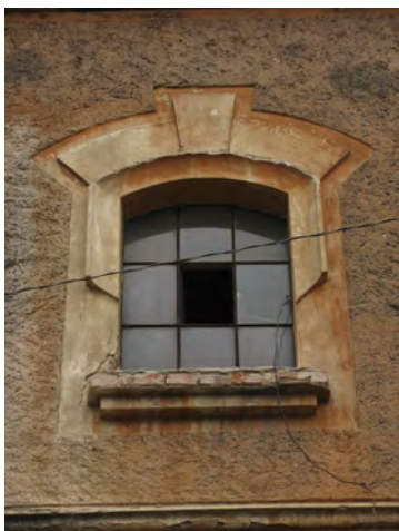
okenní otvor vyžadující opravu
