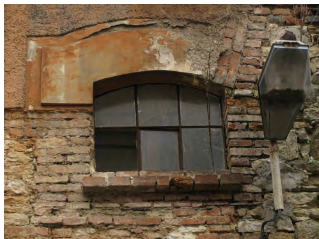
okenní otvor vyžadující opravu
