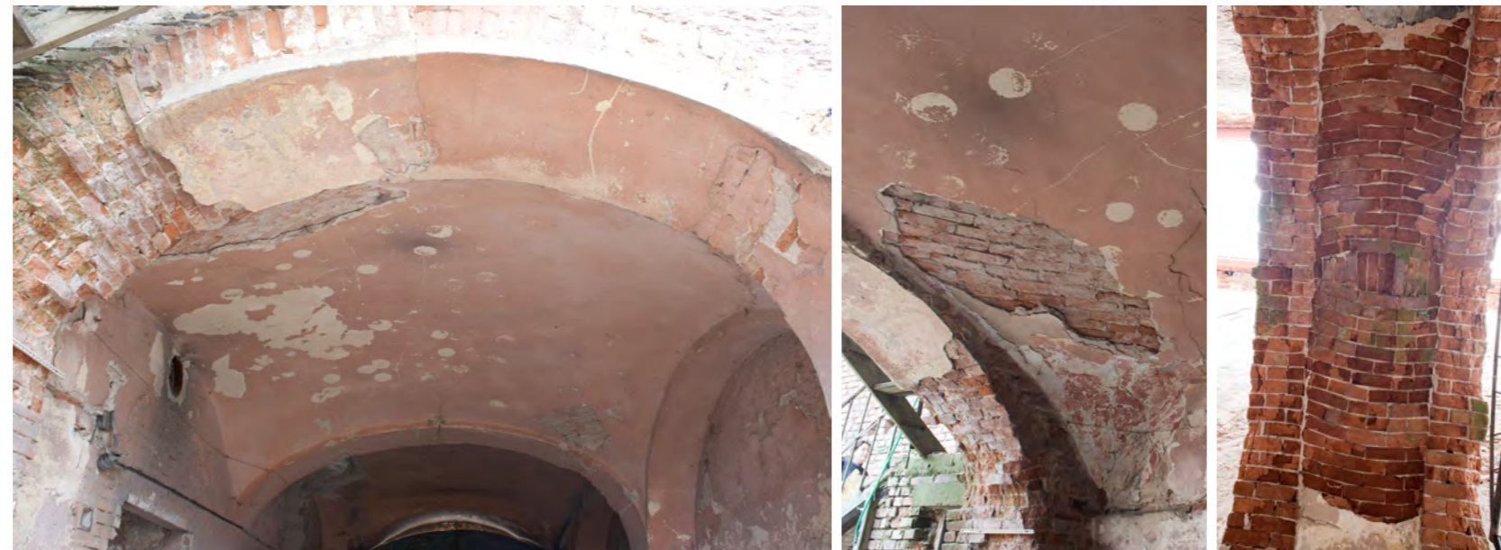
Průjezd a můstek - typická klasicistní placťová klenba s pasy. Na obnažené klenbě můstku můžeme sledovat mistrovské (tehdy běžné) provedení. Stavěno v letech 1803-5.
