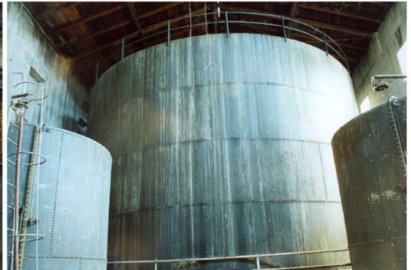
SKLAD LIHU (BLOK B) - SKLADOVACÍ TANK NA LÍH
