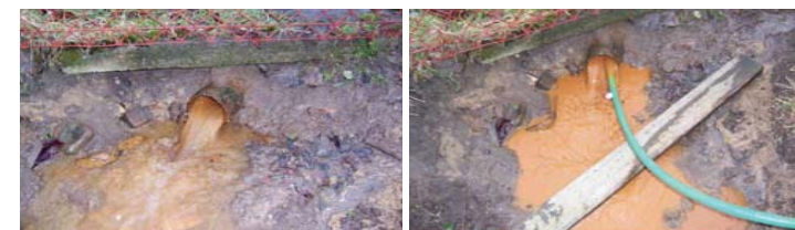
Dokumentační fotografie poškozených trubek odvodňovacích systémů.
