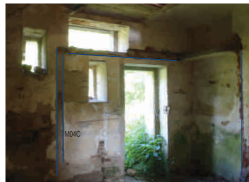
1 - pohled na stěnu s otiskem přičky od WC a zádveří
