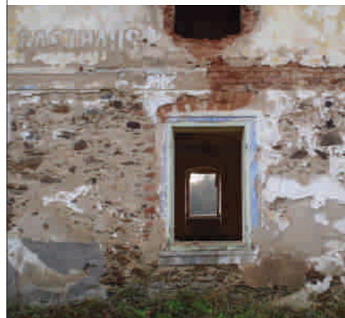
Na severovýchodním průčelí je pod odpadnou omítkou patrná struktura zdiva. Do kamenného přízemí je vloženo okno do ostění vyzděného z cihel, patro cihelné. Okolo oken jednoduché šambrány, parapet kamenný, mělice profilovaný. Patrová římsa plochá, nad ní se propisuje nápis Gasthaus. Z barevnosti je ještě patrná šmolkové, šambrány zelené, bílá a okrová.
