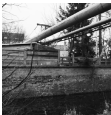
[4] zanedbané okolí severního ramene řeky, vedení tech. infrastrukturu - jediné spojení s druhým břehem
