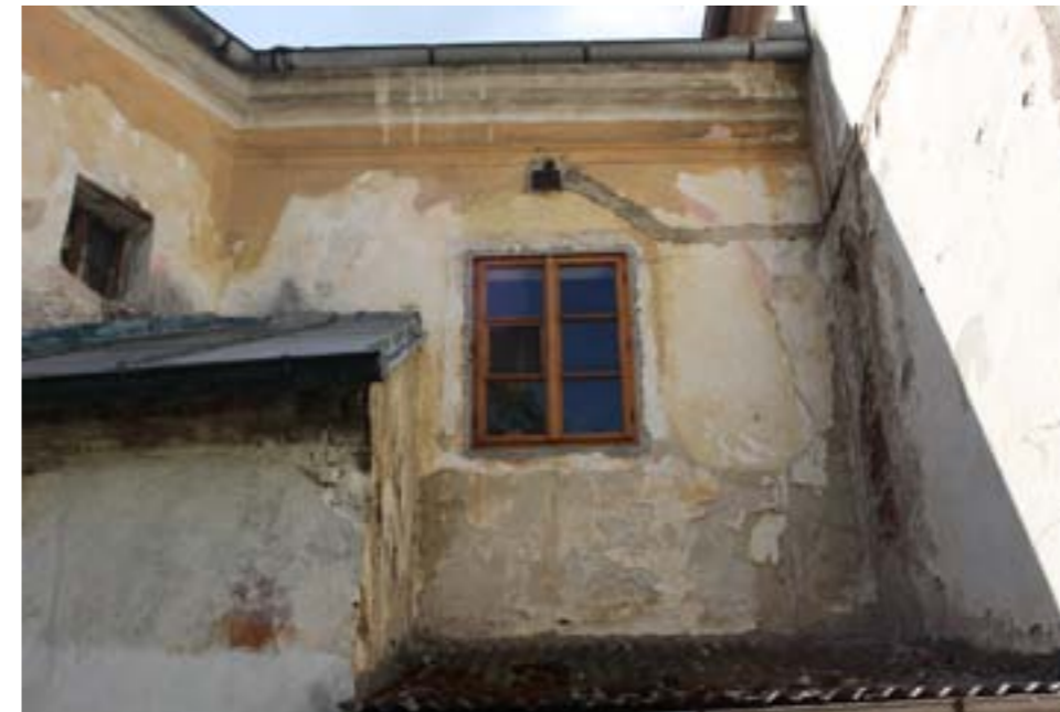
Celkový pohled na pole původní pilířové arkády na západní straně nádvoří. V opadání omítky patrná červená pasparta oblouku. Okno chodby č. 102.
