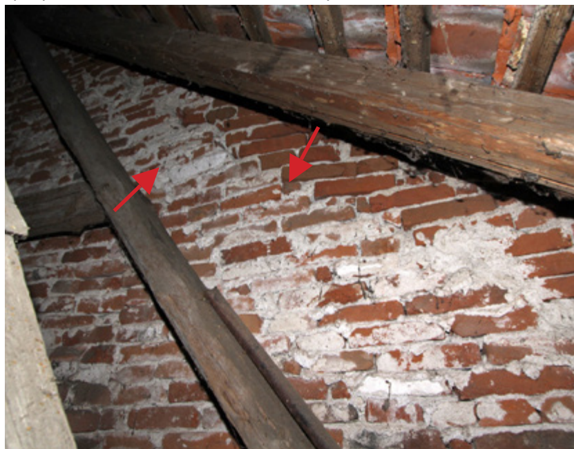
spáry svědčící o změnách sklonu střechy
