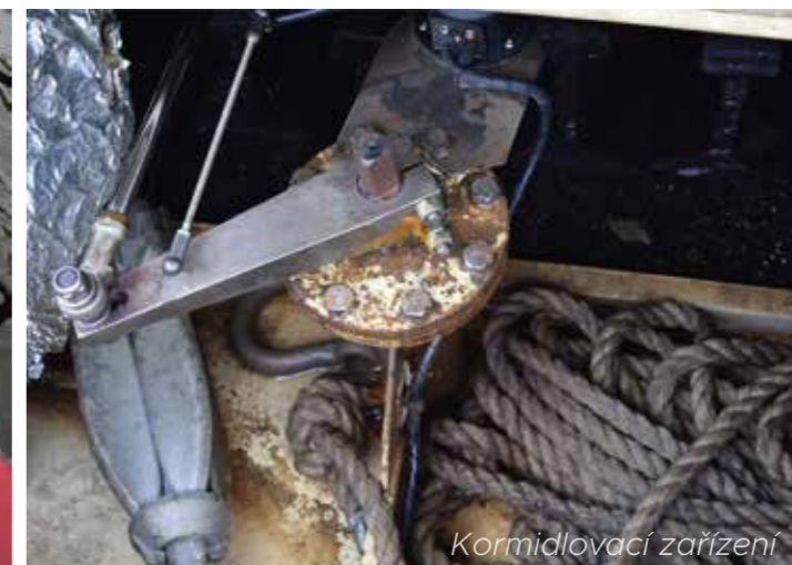
Servisní přístup kormidlovacího zařízení
