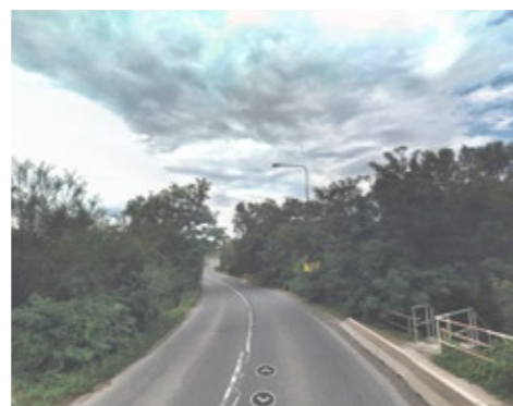
Fotografie ze středu náspu, vpravo dobíhá chodník k příkrému schodišti. Násep je kvůli havarijnímu stavu uměle zúžen.
