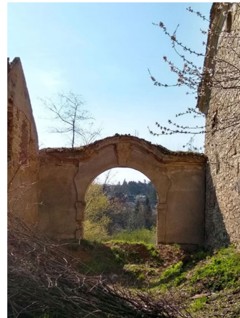
Statenický zámek - barokní brána - přes špatný stav silná.
