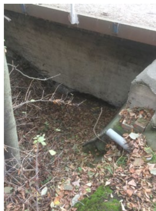
Odvodňovací prostup je dnes zanesen doslova po okraj.
