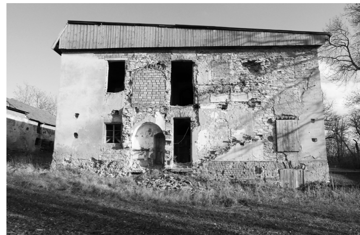
Současný stav západní fasády. Přístavek byl stržen již ve 2. polovině 20. století a fasáda byla později poničena opěrnými kůly.
