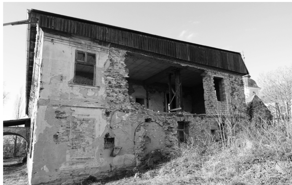
Fotografie současného stavu. Po dostavbě betonového stropu nad patrem vypadla větší část obvodové zdi v patře. Opadem omítek byly odhaleny oblouky raně barokní sala terreny.
