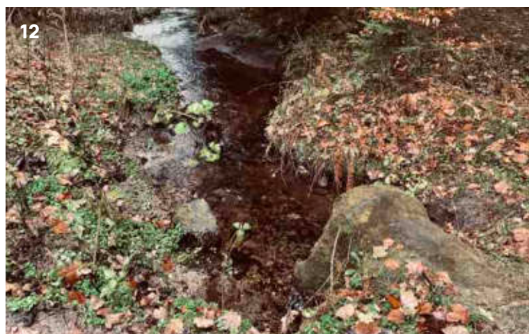
Foto č. 12. Tok je před železničním přejezdem omezen – průtok se musí vejít do úzké betonové / kameninové trubky. První větší překážka na toku.
