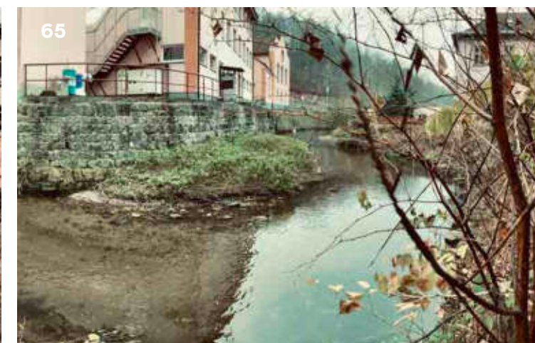
Foto č. 65. Levý břeh Nisy na začátku „úzkého“ údolí pod Prosečí. Stavby stojí na úplném okraji břehu, což je umožněno „stabilní“ postranní zdi.
