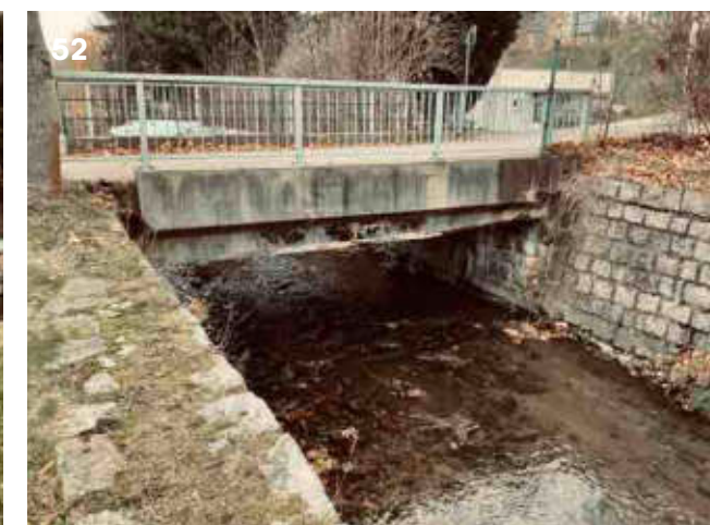
Foto č. 52. Lokální zmenšení průtočného profilu koryta. Pod mostkem také do toku vyúsťuje další roura.
