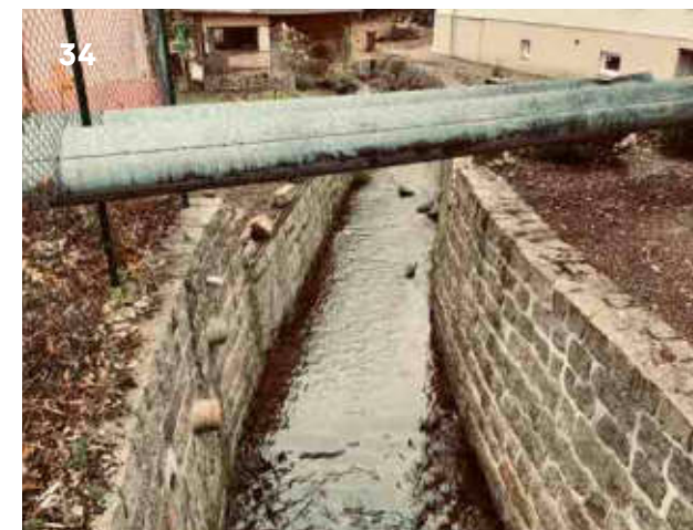
Foto. č. 34. „Pasecký kanálek“. Vlevo v opevněném břehu odvodnění z okolních pozemků do koryta.
