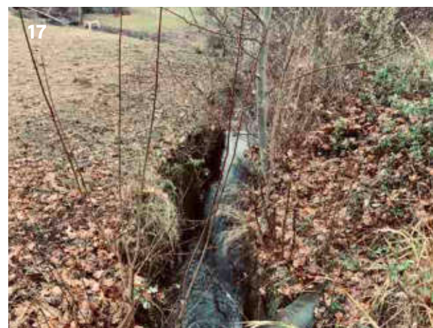
Foto č. 17. Možnost rozlivu toku je v zahlobeném, i zde relativně kapacitním korytě velmi omezena.
