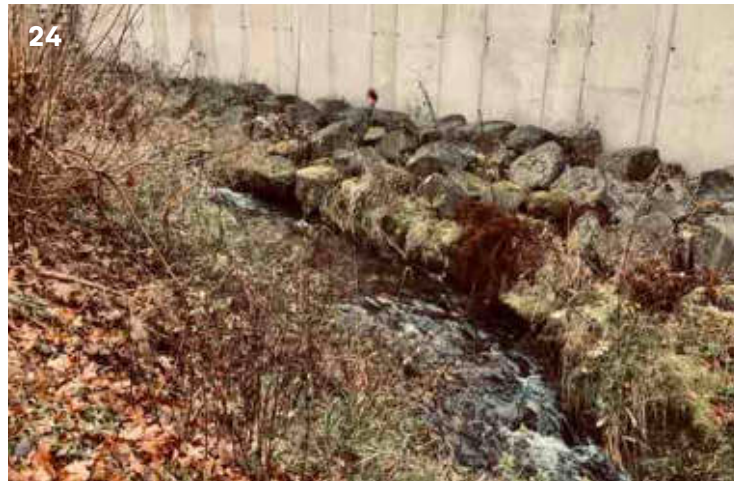
Foto. č. 24. Proud toku po soutoku se Šindelovým zrychluje. Koryto je lokálně pod mostem zpevněno kamenným záhozem.
