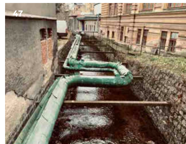
Foto č. 47. Těsně před Tyršovými sady: v korytě vodního toku vede starý parovod.
