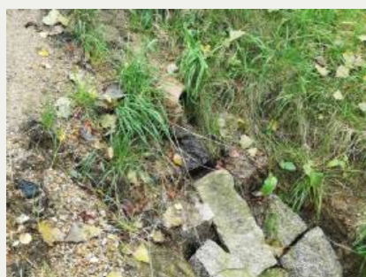
7 nevyřešený odvodňovací prvek u modráskové louky
