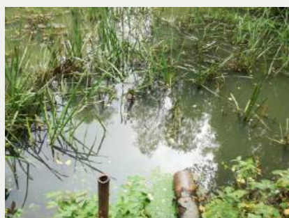
4 protrhávající se hráz rybníčku a jeho špatný stavební stav
