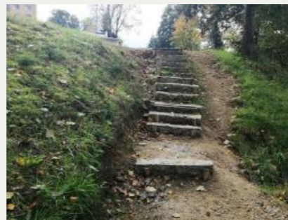
2 špatná propojenost s okolím (chybí přechody, stávající schodiště u zastávky je ve špatném stavu)
