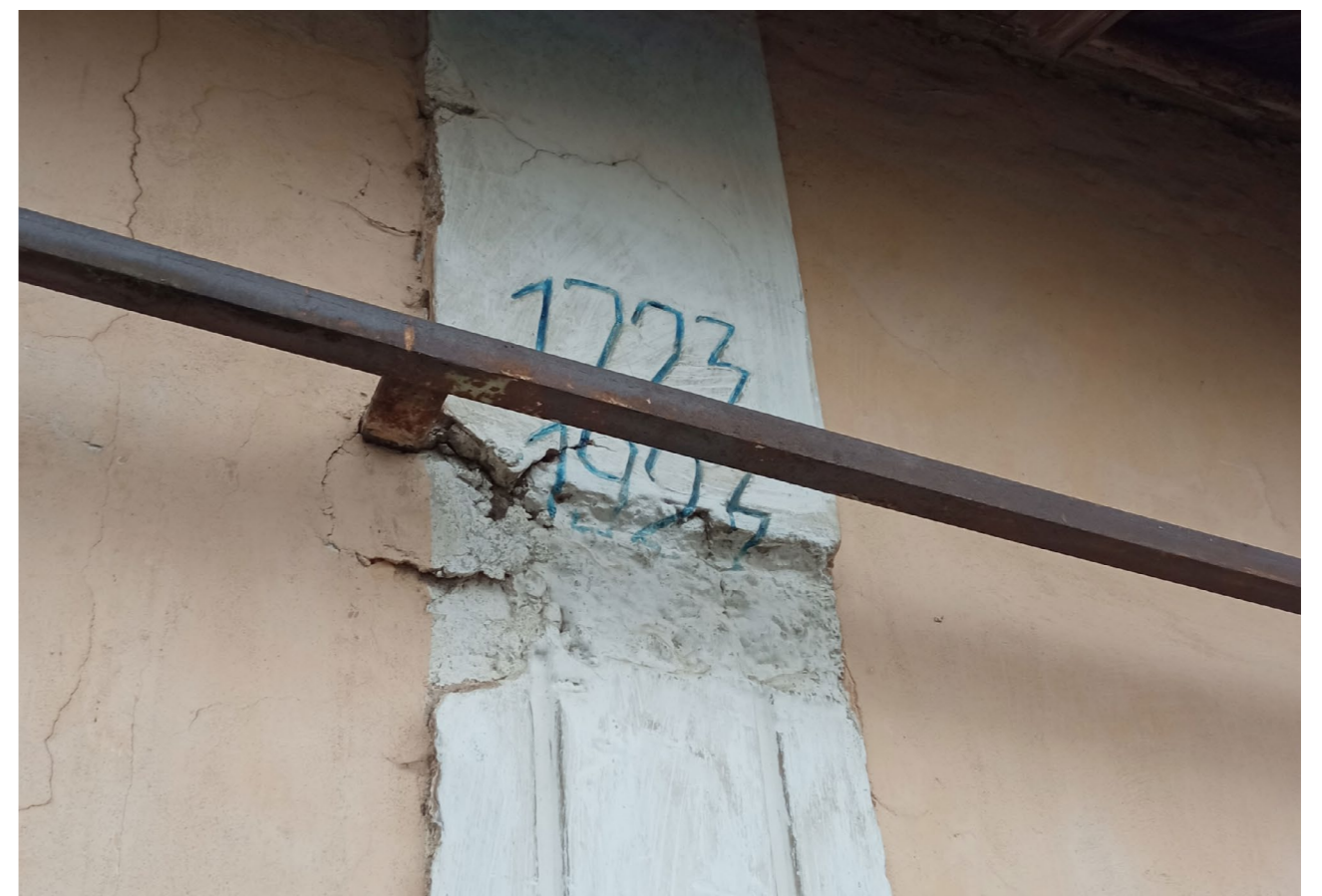
Období výstavby a přestavby obytné části vyryté na fasádě směrem k návsi.
