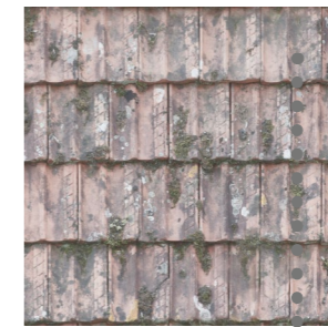
Stávající krytina Vlnovka Lokálně vyměněna
