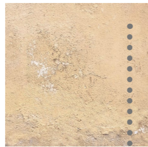
Stávající omítky Lokálně obnoven nátěr
