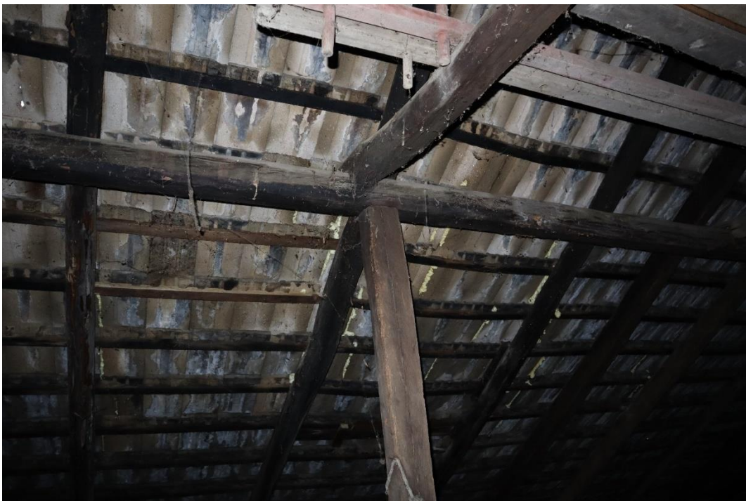
Poškodenie časti krovu v mieste bývalého komína, kde zatekala niekoľko rokov voda.
