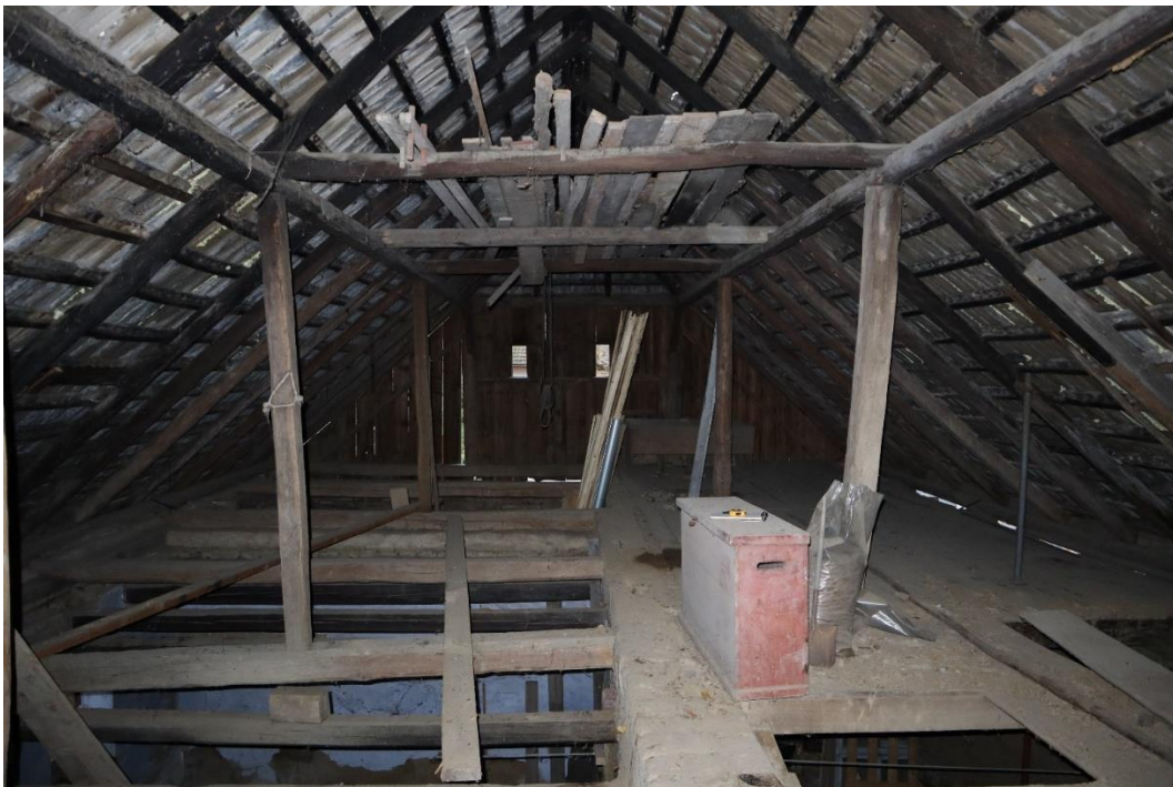
Pohľad do krovu na štít. Odhalené sú aj stropné trámy kvôli chýbajúcemu záklopu.
