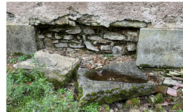
sokl - opadané pískovcové bloky ovčín východní fasáda
