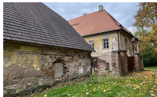
jižní část s probouraným otvorem ohradní zed' z 2. pol. 20. stol ovčín východní fasáda, Kavaliierhaus v pozadí
