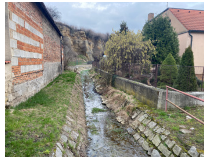
Opevněné koryto v intravilánu obce Sluhy, které se potýká s povodněmi s velmi omezenými možnostmi zkapacitnění koryta potoka.
