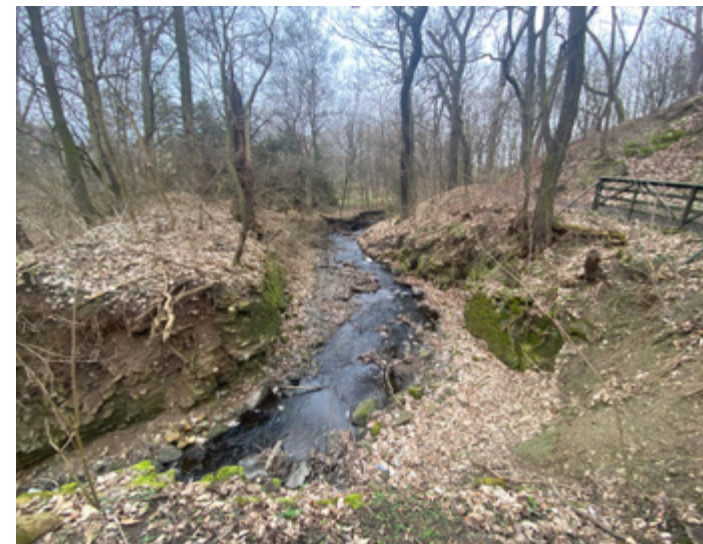
Pozůstatek hráze před náhonem k Miškovickému mlýnu a stále se prohlubující koryto.
