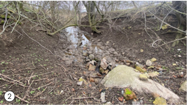
Vyústění potrubí hlavního odvodňovacího zařízení uprostřed prameniště Mratínského potoka. Navazuje otevřený zahloubený odvod. kanál.
