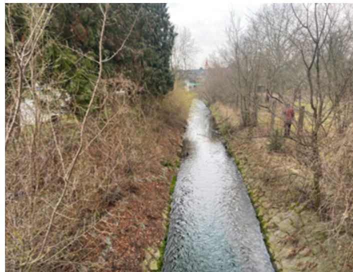
Koryto Mratínského potoka s malou hrubostí dna protékající mezi zahrádkami v obci Sluhy.
