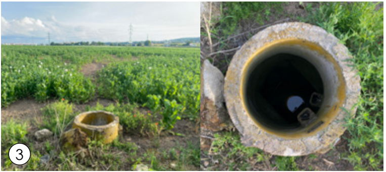
Vstupní šachty do systému odvodnění.
