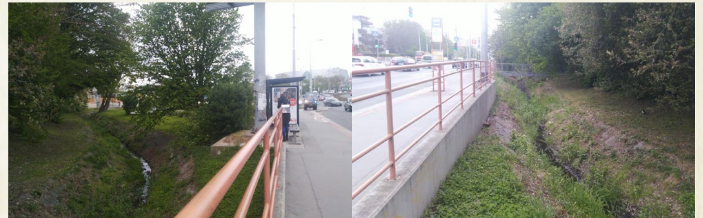
Obr. 37: Nevhodný vstup k říční hladině v parkově upravené ploše na křižovatce ulic Švehlova a Pražská
