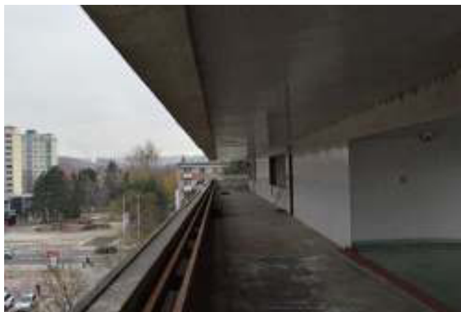
Fig.79 Pohľad na východ na balkóne 4.NP
