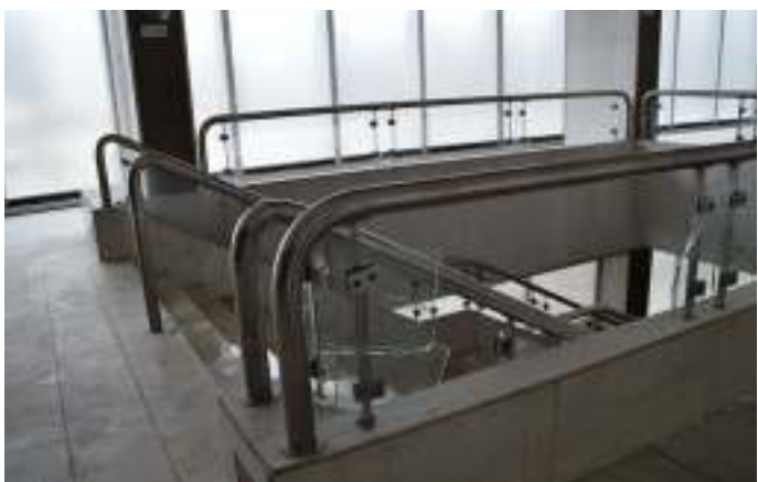
Fig.135 Obrázok , kovové zábradlie so sklenenými výplňami; Zdroj: autor. fotografia
