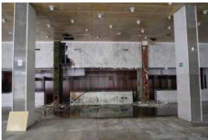
Fig.86 Degradácia stĺpov a obkladov vo vestibule estrády
