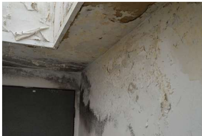
Fig.213 3-61, vlhkosť na stene a pri vstupe na vonkajší balkón
