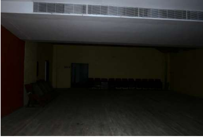
Fig.242 0-74, pohľad do sály, vzduchotechnika v podhlade
