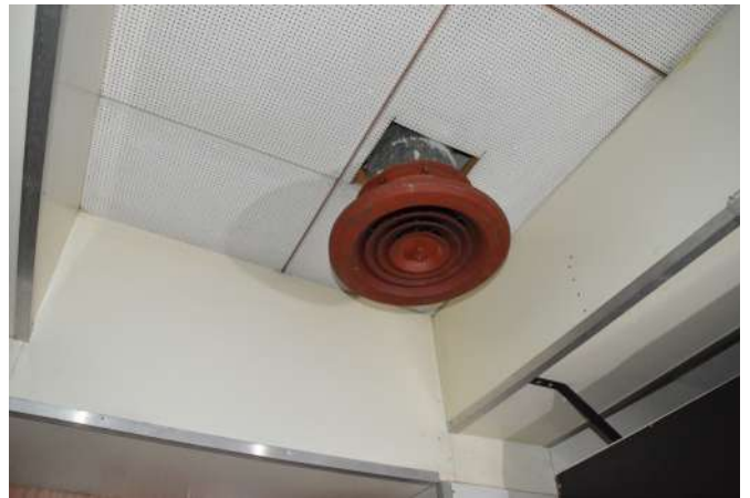
Fig.200 3-21, vzduchotechnika zvukovej réžie
