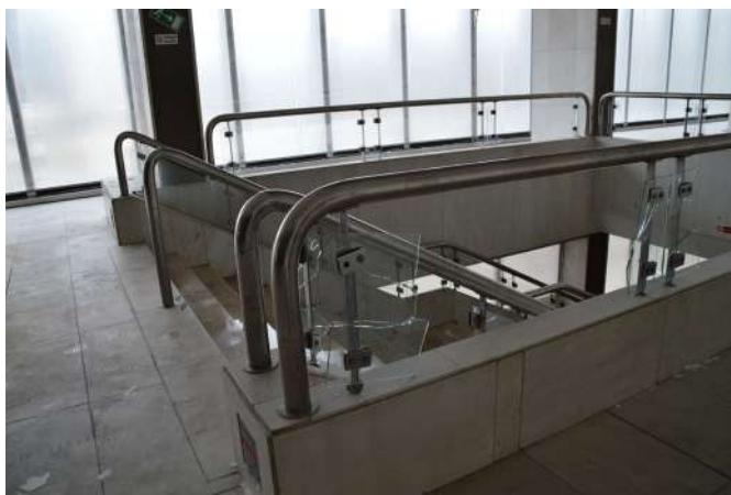
Fig.189 Pôvodné zábradlie, rozbité výplne
