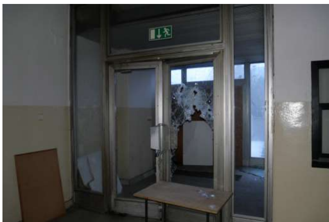
Fig.182 1-47, zavesenie, rozbité sklo na obidvoch dverách
