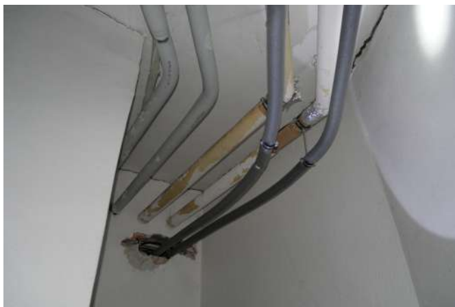
Fig.109 0-8 prázdna miestnosť, trhlina v strope
