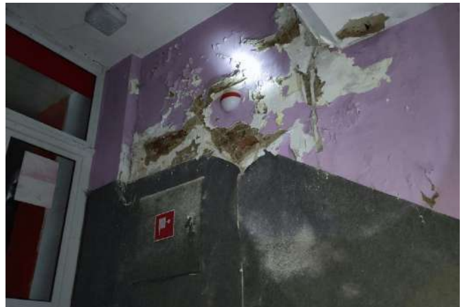
Fig.246 0-73, vlhkosť na stene schodiska
