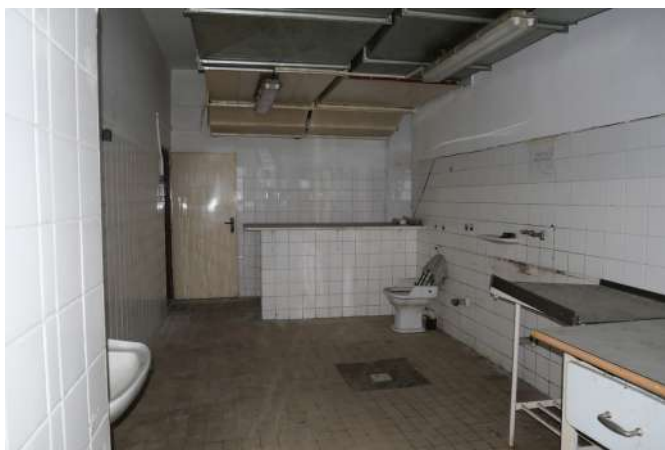
Fig.116 1-8 prázdna miesnosť, trhlina v strope
