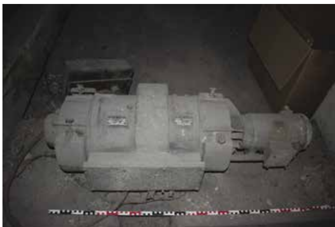
Obr. 27. Praha 2-Nové Město, čp. 2026, Ke Karlovu 5, budova Matematicko-fyzikálního ústavu UK. Motor-dynamo umístěné na půdě MFF UK na Karlově (foto autor, 2018).
