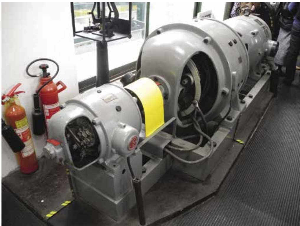
Obr. 23. Praha 1-Hradčany, ppč. 279/1, strojovna pozemní lanové dráhy na Petřín. Ward-Leonardovo soustrojí z roku 1931, jež dodnes pohání lanovou dráhu na Petřín (foto autor, 2011).
