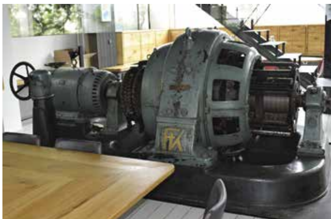
Obr. 26. Praha 5-Hlubočepy, ppč. 883/8, bývalá měnárna Barrandovských filmových studií. Rotační měnič o výkonu 500 kW od firmy František Křížik zachovaný v dnes konvertované bývalé filmářské areálové měnárně Barrandov (foto autor, 2019).
