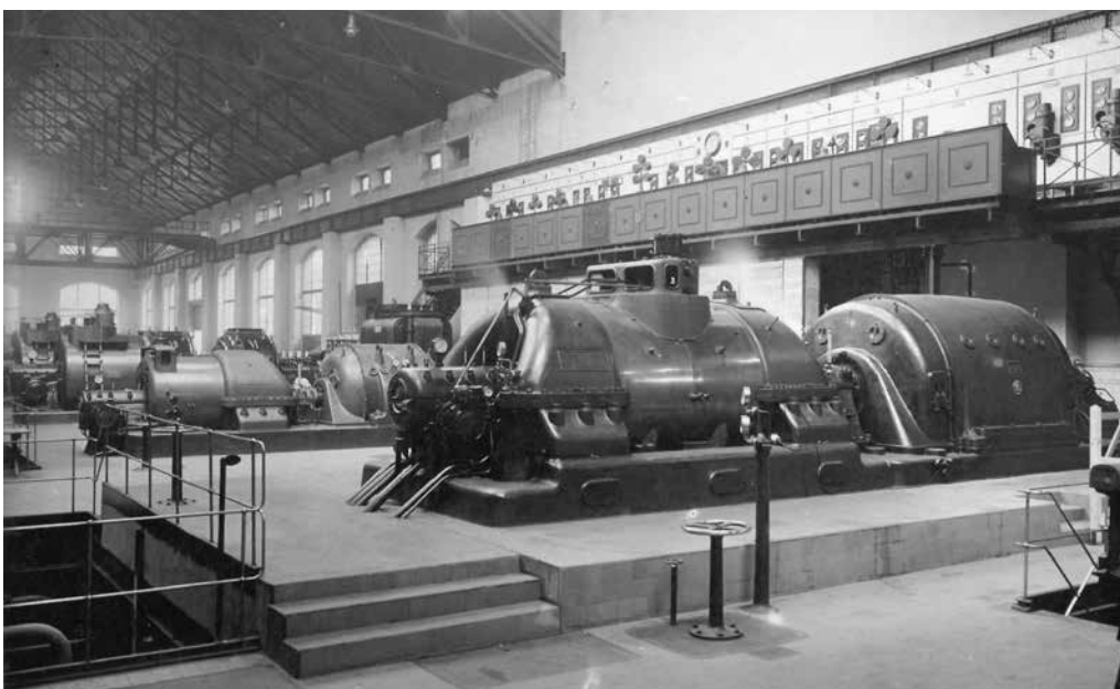
Obr. 11. Praha 7-Holešovice, čp. 1 a 218, ppč. 1/25 a 1/26, elektrárna Holešovice. Pohled do strojovny parní elektrárny Holešovice čp. 1, ppč. 1/26, na historické fotografii z roku 1928 (soukromá sbírka autora).
