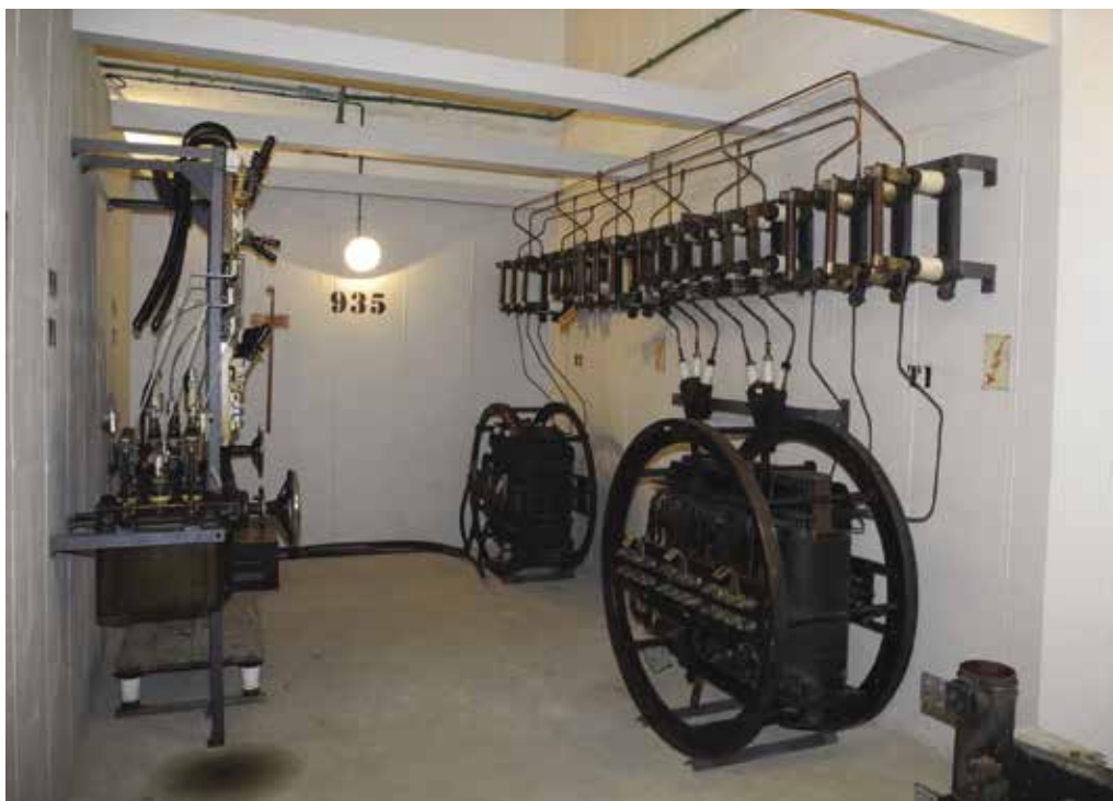
Obr. 1. Praha 7-Holešovice, čp. 960, Jankovcova 40. Expozice rozvodny/distribuční transformační stanice z 20. let minulého století v typickém pražském domovním suterénu, sestavená v Muzeu PRE v pražských Holešovicích. Vpravo – dva třífázové transformátory, nahore – vývody nn 0,4 kV, vlevo odpojovače vn 3 kV (foto autor, 2016).
