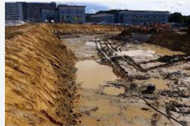
● I takto může vypadat zemní pláň. Veškerou rozbředlou zeminu je třeba odstranit a nahradit novou. Na tomto snímku je vidět, jak důležité je co nejdříve zemní pláň odvodnit a nevystavovat ji vlivu počasí během zimního období.
