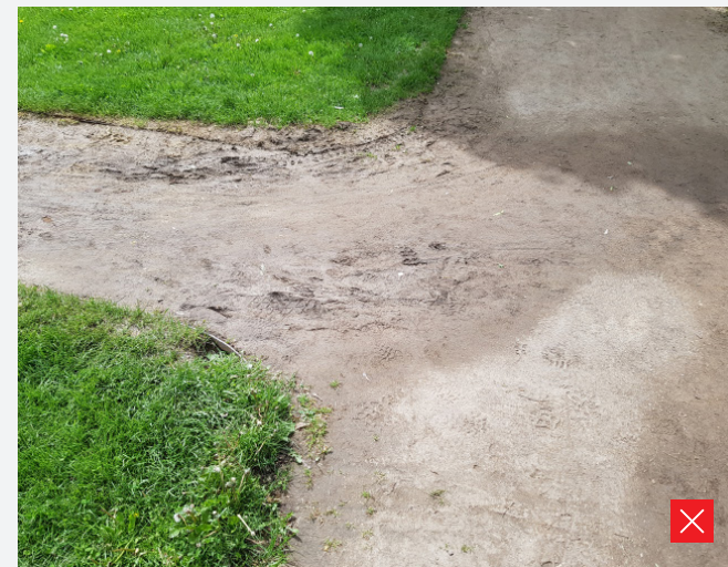
● Nefunkční či neudržované odvodnění způsobuje rychlou degradaci mlatu zamokřením.
